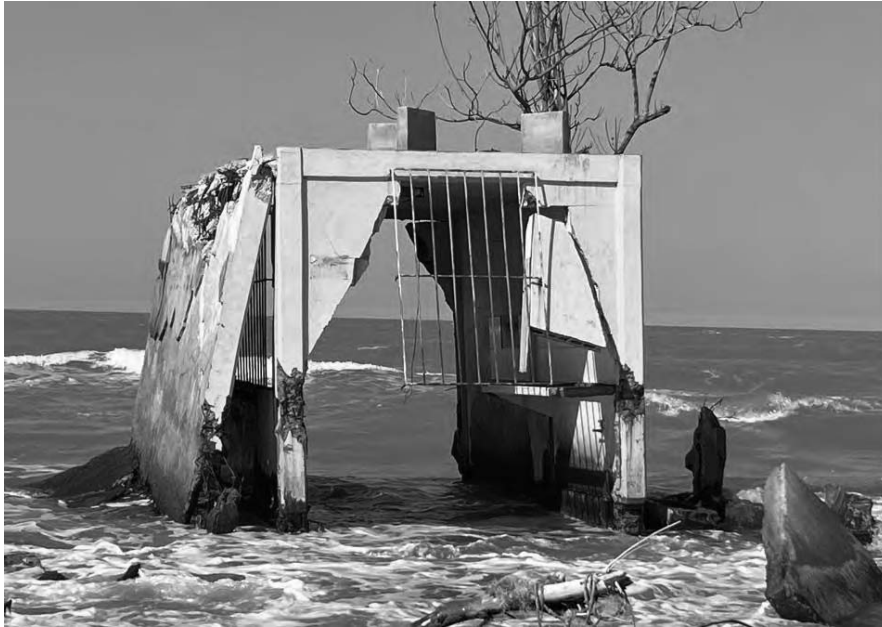
Ilustración 38. Equipamiento destruido por la erosión e incremento del nivel del mar
